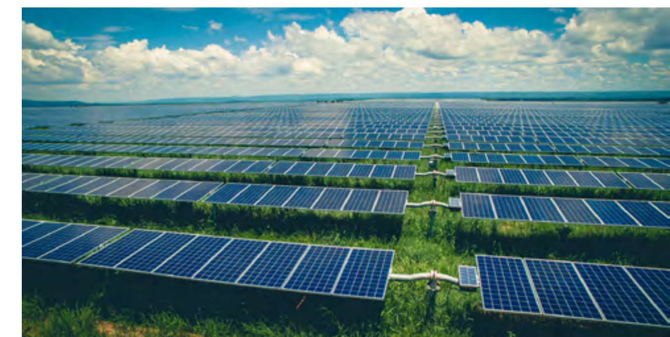
Usinas Fotovoltaicas Pirapora.
